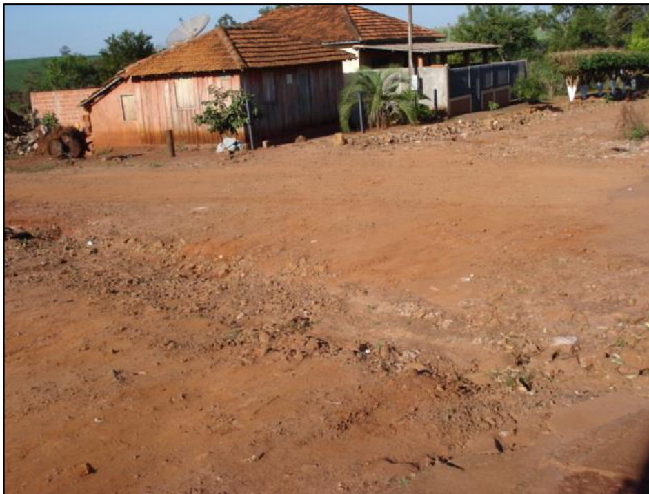
Figura 8.4 – Inexistência de sistema de drenagem urbana e dissipador de energia
