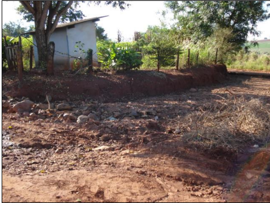
Figura 8.5 – Inexistência de sistema de drenagem urbana e dissipador de energia
