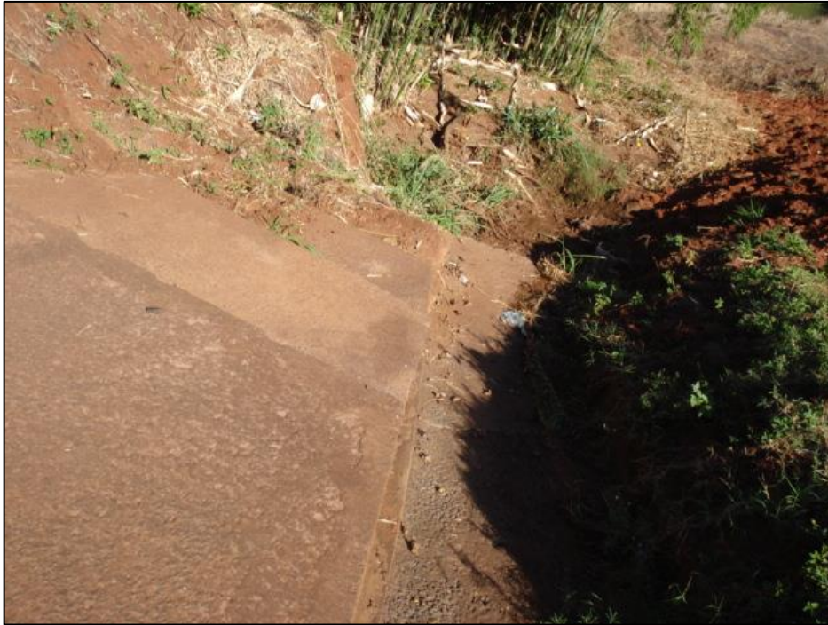
Figura 8.7 – Dissipador de energia em mal estado de conservação, se mostrando ineficiente
