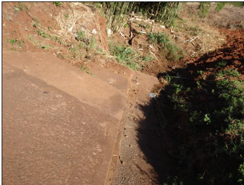
Figura 8.2 – Dissipador de energia em mal estado de conservação, se mostrando ineficiente
