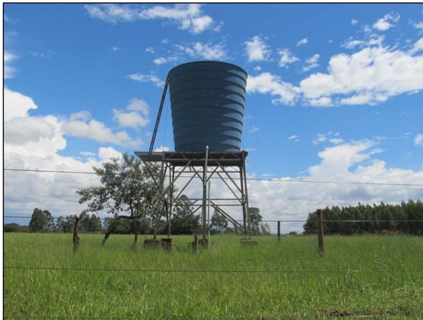
Figura 6.3 – Poço e reservatório na região da ASAFAPEM - água contaminada
