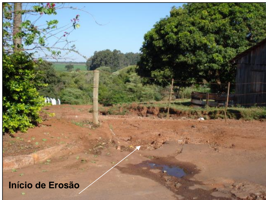
Figura 8.8 – Inexistência de dissipador de energia no final do sistema de drenagem
