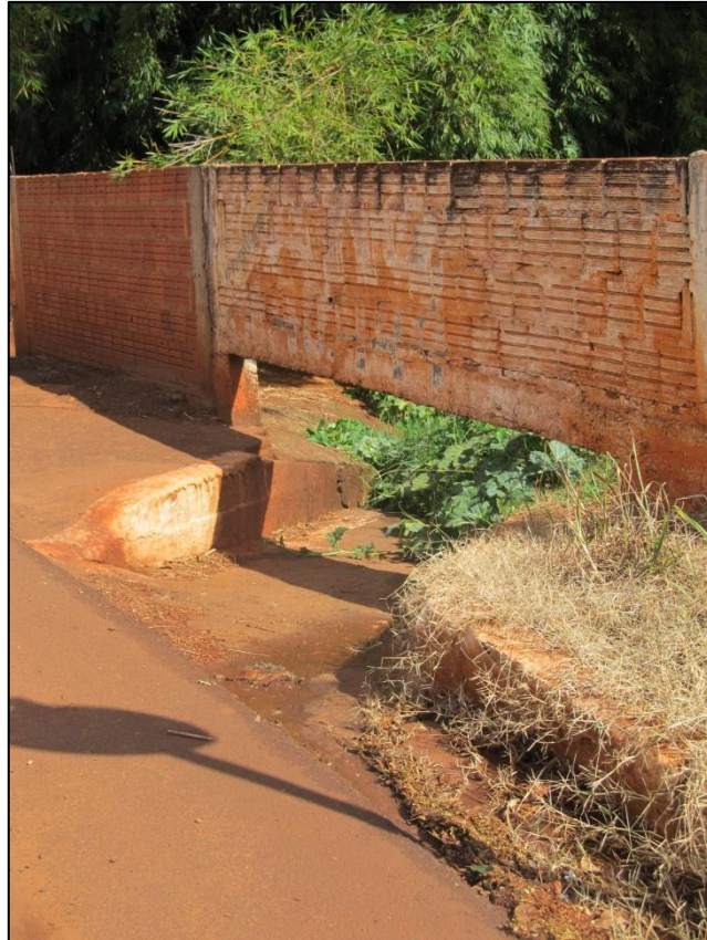
Figura 8.9 – Dissipador de energia com falta de manutenção
