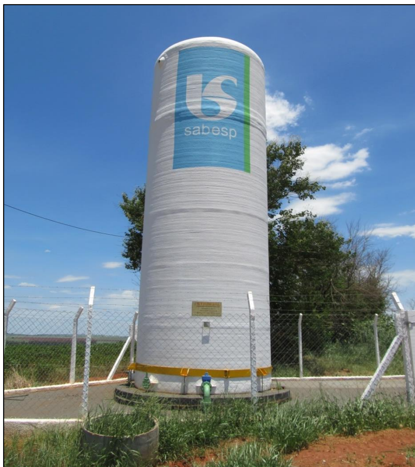
Figura 6.6 - Reservatório (2) de água do município.
