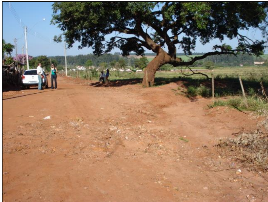
Figura 8.6 – Inexistência de sistema de drenagem urbana e dissipador de energia
