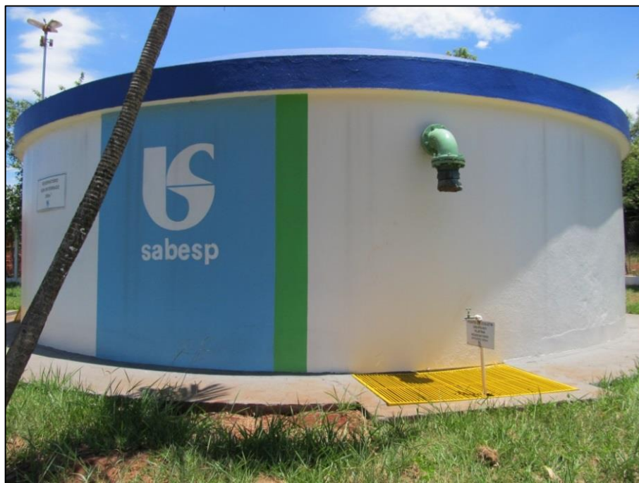
Figura 6.5 - Reservatório (1) de água do município.
